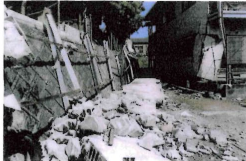
2016年4月に発生した熊本地震の前津で倒壊したブロック塀。下敷きになった男性(当時29歳)が亡くなり、女性(当時57歳)が足を骨折して今日も歩行困難が続いている(写真:放送局の写真が提供) [図説のクリックで拡大表示]
