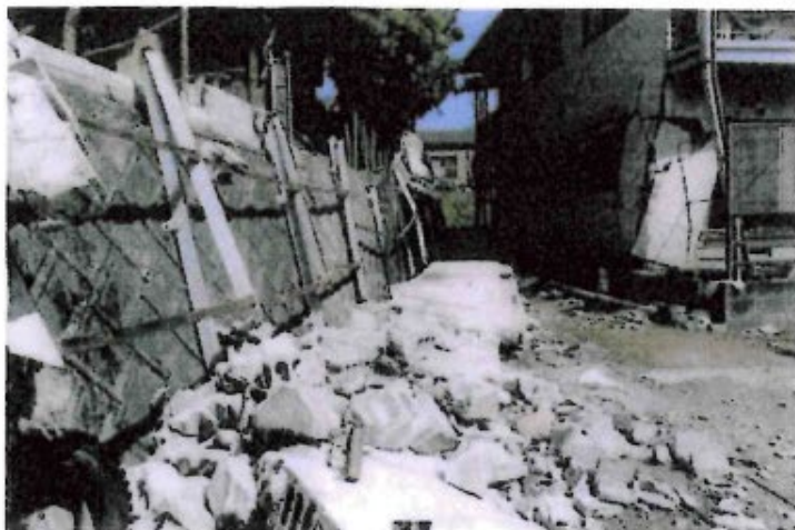
2016年4月に発生した熊本地震の前震で倒壊したブロック塀。下敷きになった男性（当時29歳）が亡くなり、女性（当時57歳）が足を骨折して今日も歩行困難が続いている（写真：被害者の関係者が提供） 【画像のクリックで拡大表示】
