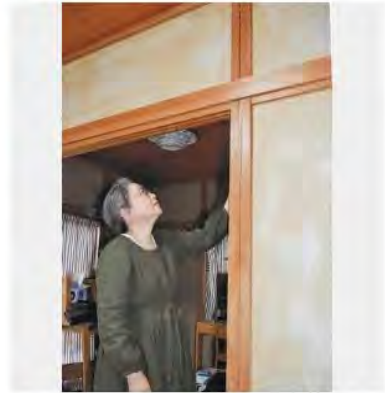
自宅2階で、地震で床から天井まで縦にひびが入ったままの柱を見る菅沢さん
