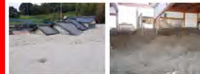
【平成29年九州北部豪雨での土砂堆積等による住家被害の例】
